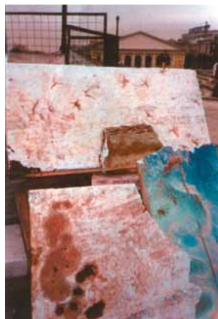
Рис. 1. Внешний вид пенополистирольных плит через два года эксплуатации покрытия подземного торгового комплекса на Манежной площади в г. Москве
