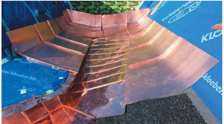
Пологий участок кровли между двумя различными конструкциями (снежный мешок) выполнен картинками в технике двойного стоячего и лежачего фальцев. Слева – картины со стандартными прямыми конвертами (круглогубцы), справа – скругленные безконвертные фальцы (гофрователь)
