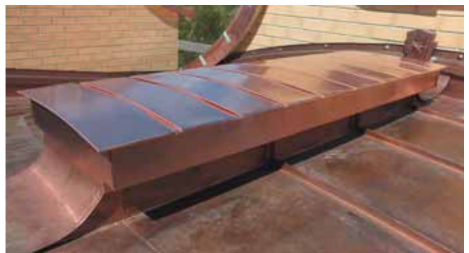
(з) Общий вид конькового аэратора на фальцевой кровле арочного типа
