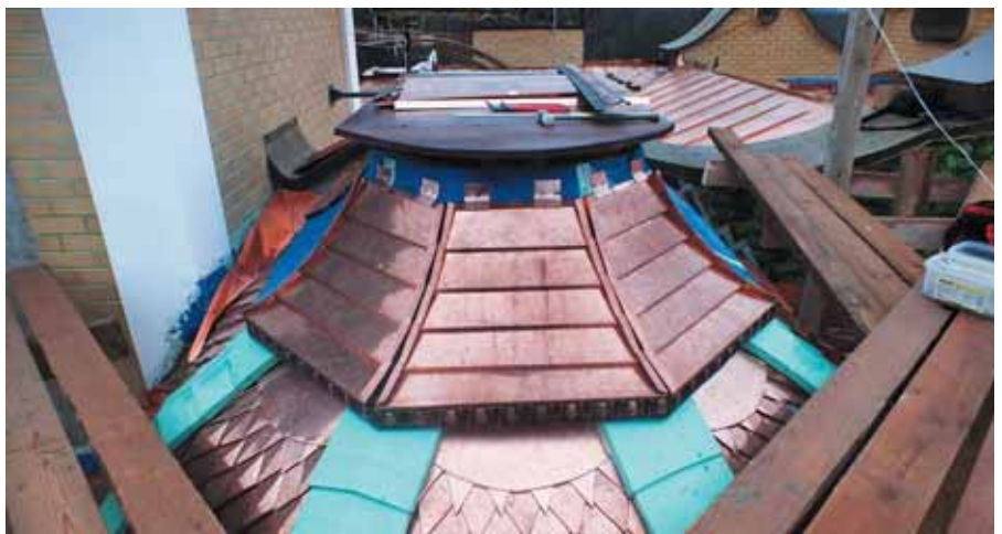
Завершающий этап работы по декорированию наверхия купола гонтами с малой амплитуды подъема по вогнутой поверхности с применением специальной развертки – трапецидальная форма
