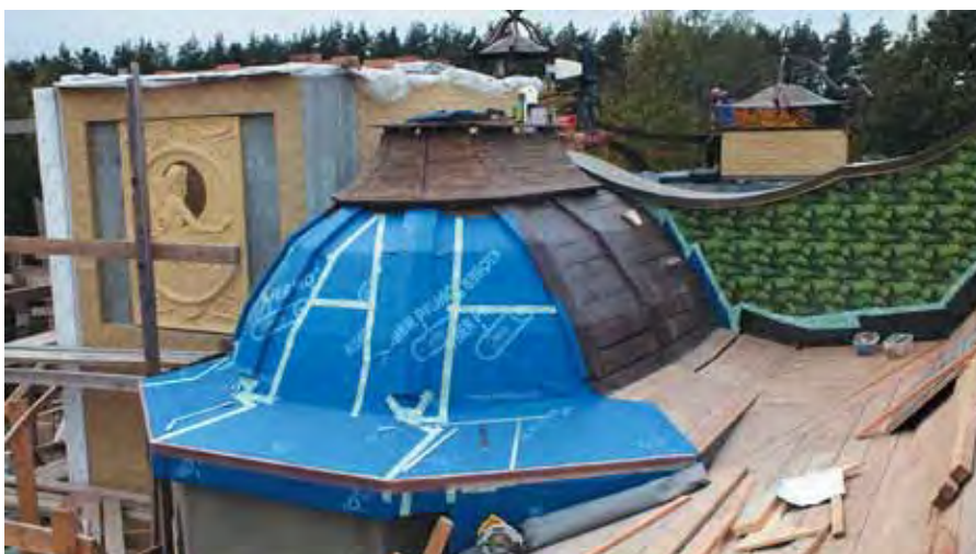
Устройство сплошного основания и укладка синтетической изоляции Klover Extreme по всей поверхности каркаса купола с применением специального армированного скотча D-Tack Tacoflex
