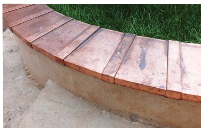
Рис. 15. Защитное обрамление небольшого радиусного участка бетонного забора расположенного на внутридомовой территории переходящего с внешней стороны участка выполненного в декоративной технике сегментными элементами имеющих равные стороны по ширине на внешней рейке с применением скрытых закладных элементов для повышения антивандальной прочности защитного покрытия.
