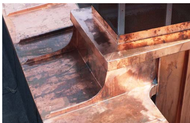
Рис. 12. Вентиляционная труба примыкающая к парапету жилого дома: примыкание задней части трубы – картина с полукруглыми конвертами (категория А) в технике углового фальца; боковые части труб – частично цельная картина с применением низкотемпературной пайки.
