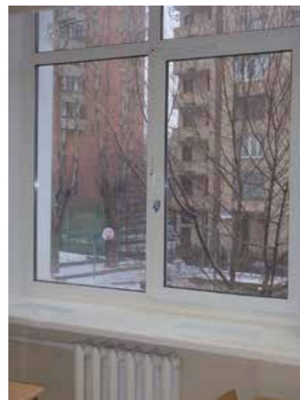
Решетки в подоконнике и приточный клапан в школе
