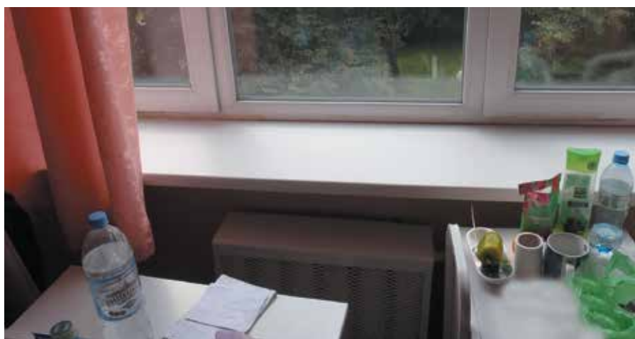
Батарея закрыта подоконником и декоративным экраном
