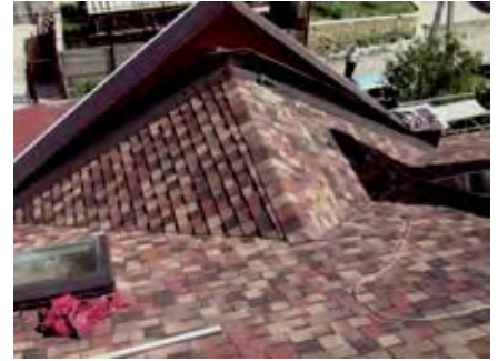
Ошибки: элементом примыкания к парапету использован ендовный ковер, который уложен поверх гибкой черепицы
