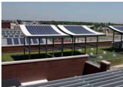
Uni-Solar® тонкопленочный фотоэлектрический (PV) ламинат по TPO- мембране на приподнятых участках крыши.
