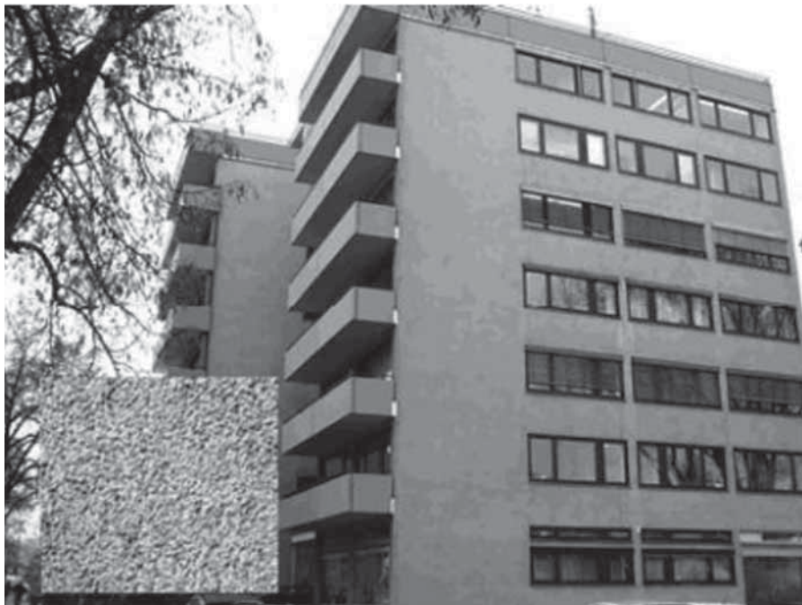
Рис. 4 Восточный и южный фасады (справа налево) объекта 54 в Ноймаркте в декабре 2004 г., спустя 16 лет после ремонтных работ, заключавшихся в нанесении нового покрытия. В левом нижнем углу – увеличенный фрагмент штукатурки над маленьким окном.
