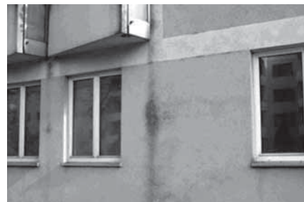
Рис. 7. Локальное образование водорослей вдоль участка с концентрацией стока дождевой воды, вызванного боковым ограничением балконом и ветром.
