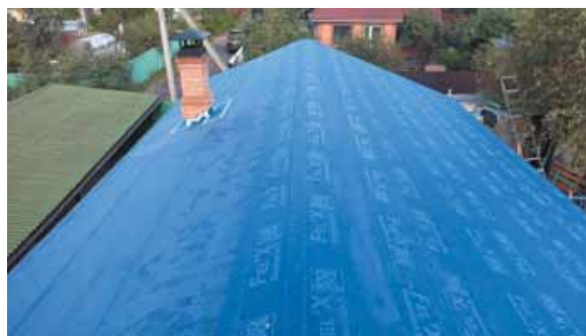
Укладка битумного подкладочного ковра ICOPAL по сплошному основанию выполненного из обрезных досок толщиной 25 мм
