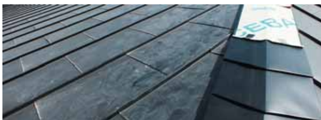
Укладка изготовленных вручную декоративных облицовочных элементов на хребтах кровли с применением дополнительной изоляции в виде специального тонкого самоклеющегося битумного ковра Tegola Icebar
