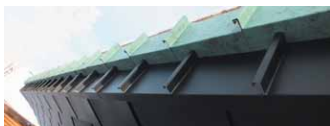
Обрамление двухуровневой лобовой доски выполнено в виде малых фальцевых картин закрепленных в шахматном порядке (техника декоративного Г-образного стоячего фальца)
