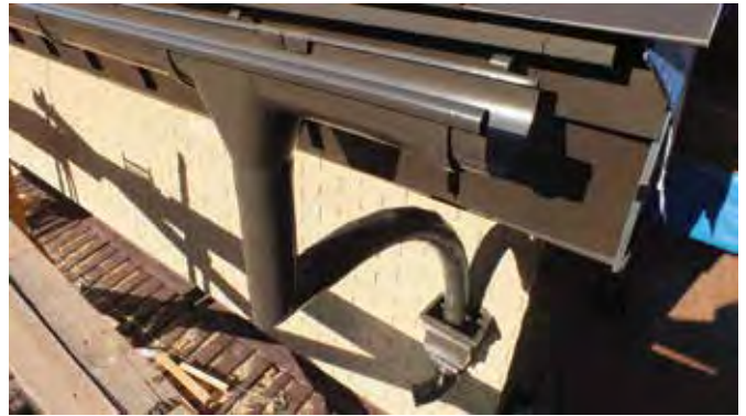
Общий вид швейцарского колена и водосборной пристенной декоративной воронки
