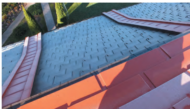
Общий вид игры форм и теней декоративных типов кровельного покрытия с комплексным применением снегозадержания и водосточной системой
