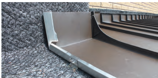
ж) вид рядовой картины со стороны имеющей прямой и полукруглый конверты (двойной фальц) с примыканием высотой 150+25 мм к вертикальной части короба фронтона кровли
