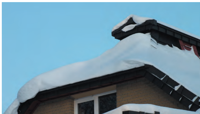
Большой объем снежной массы на карнизном свесе вальмы показал эффективность применения установки точечных снегозадержателей ручной работы
