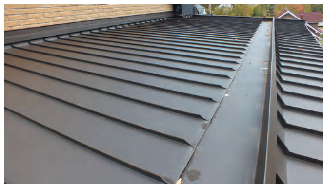
Общий боковой вид укладки прямых фальцевых картин шириной 300 мм на верхнем навесе со стороны водоотводящего лотка
