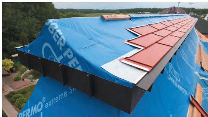
Процесс проведения монтажных видов работ по укладке декоративной алюминиевой черепицы ручной работы
