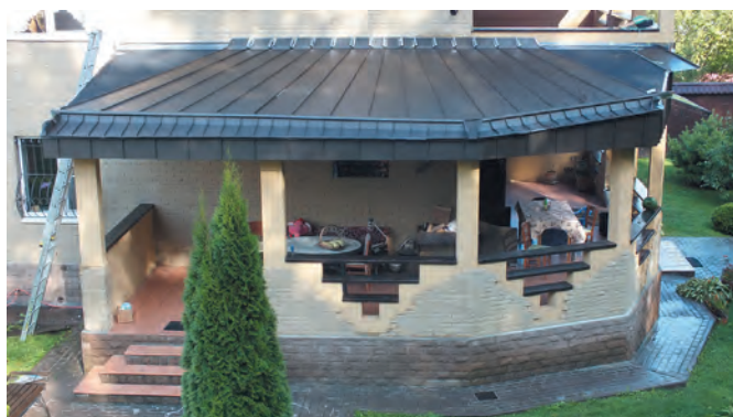
Общий вид хода монтажа кровельных работ по укладке фальцевых картин на нижнем навесе (верная укладка)
