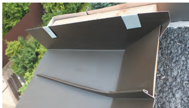
Угловая картина лежащего водостока выполнена в технике двойного стоячего фальца (лотковый и прямой конверты)
