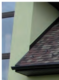
Ошибки: отсутств мыкания
