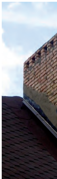
Ошибки: ендовный гибкой черепицы неправильной ра неправильно; дымо быть оштукатурен кровельного покр
