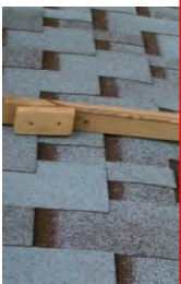
Ошибки: плоский монтаж неправильно смонтированной системы и сплошной кровли
