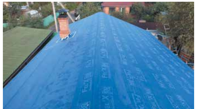
Укладка битумного подкладочного ковра ICOPAL по сплошному основанию выполненного из обрезных досок толщиной 25 мм
