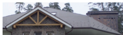
Ошибки: на переднем скате кровли полностью отсутствует вентиляция подкровельного пространства (за исключением двухскатного выступа кровли); отсутствуют аэраторы точечного типа
