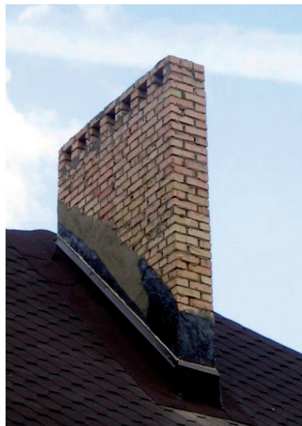
Ошибки: ендовный ковер уложен поверх гибкой черепицы; планка примыкания неправильной развертки смонтирована неправильно; дымоходная труба должна быть оштукатурена до начала монтажа кровельного покрытия
