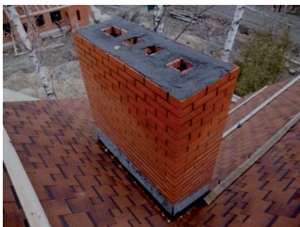
Ошибки: не выполнен монтаж разуклонки за дымоходной трубой, что приведет к образованию снежного мешка, скапливанию листьев, талой и дождевой влаги
