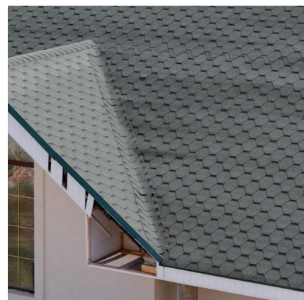
Ошибки: В линии ендовы поверх рядовой черепицы смонтированной по двум сторонам ската внахлест уложена также рядовая черепица
