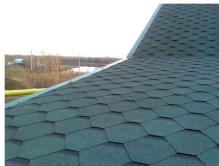
Ошибки: крепление торцевой планки произведено поверх гибкой черепицы
