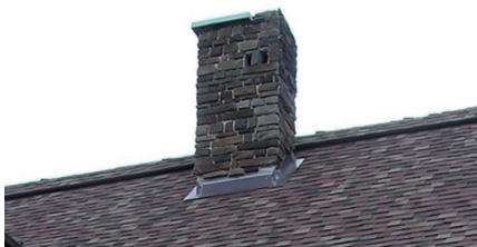
Ошибки: боковые части примыкания дымоходной трубы выполнены по типу выдры с ошибкой – планка примыкания смонтирована поверх черепицы
