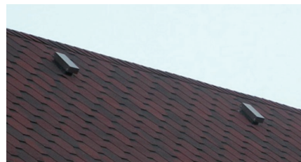
Ошибки: объема вентиляции в области конька за счет установки нескольких точечных аэраторов взамен сплошному коньковому аэратору явно недостаточно
