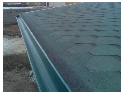
Ошибки: в качестве коньково-карнизной черепицы на карнизном свесе использован перевернутый гонт рядовой черепицы
