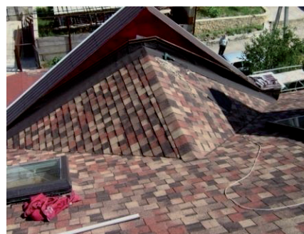
Ошибки: элементом примыкания к парапету использован ендовный ковер, который уложен поверх гибкой черепицы
