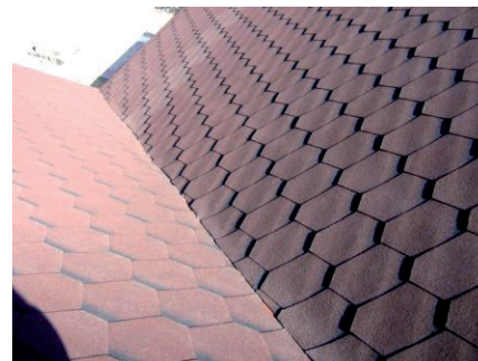
Ошибки: рядовая черепица в линии ендовы смонтирована в стык; ендова будет забита мусором от деревьев и т.п.
