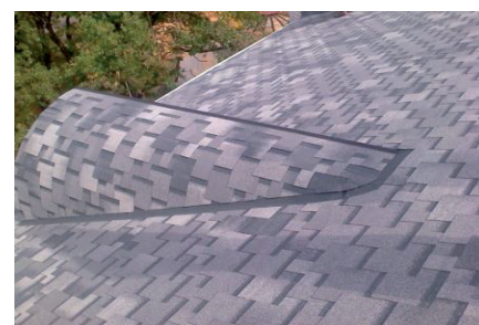
Ошибки: монтаж слуховых окон «половинок» на холодном чердаке в качестве вентиляции выполнены без какой-либо необходимости, что привело к нарушению общего экстерьера скатной кровли
