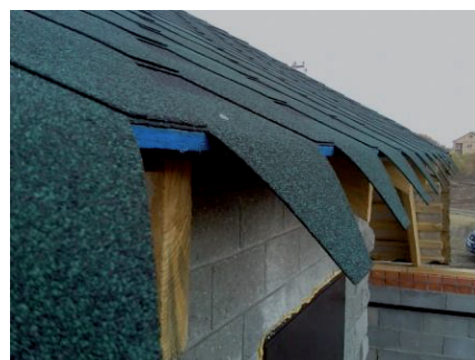
Ошибки: лепестки черепицы свисают с карниза, отсутствует карнизная планка, а также ветровая доска и подшивка карнизного свеса
