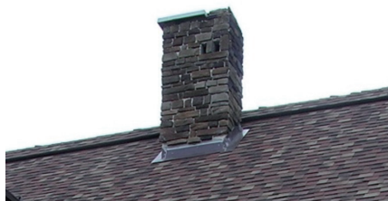
Ошибки: боковые части примыкания дымоходной трубы выполнены по типу выдры с ошибкой – планка примыкания смонтирована поверх черепицы
