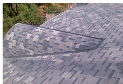
Ошибки: монтаж слуховых окон «половинок» на холодном чердаке в качестве вентиляции выполнены без какой-либо необходимости, что привело к нарушению общего экстерьера скатной кровли
