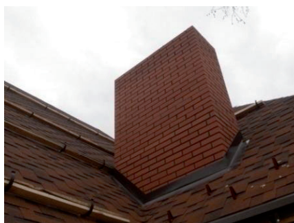
Ошибки: примыкание в правой части дымоходной трубы выполнено неправильно – планка примыкания смонтирована поверх гибкой черепицы
