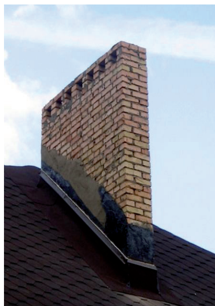
Ошибки: ендовый ковер уложен поверх гибкой черепицы; планка примыкания неправильной развертки смонтирована неправильно; дымоходная труба должна быть оштукатурена до начала монтажа кровельного покрытия
