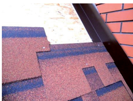
Ошибки: черепица уложена без использования подкладочного ковра поверх планки примыкания в сопряжении с вертикальной поверхностью
