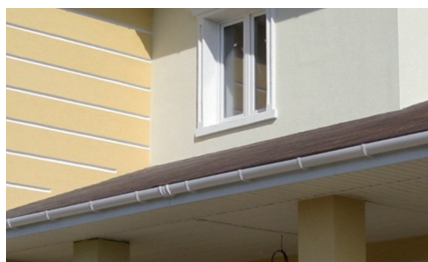
Ошибки: в зоне примыкания кровли к стене под окном отсутствует выход воздуха из подкровельного пространства
