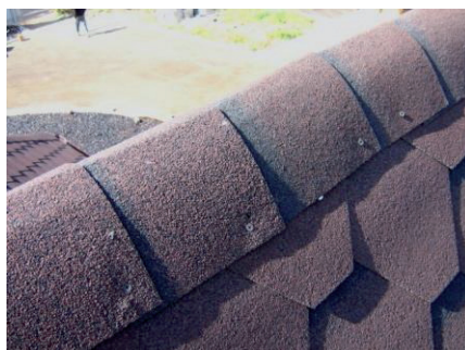
Ошибки: крепление коньково-карнизной черепицы (ККЧ) выполнено не специальными кровельными гвоздями, а обычными фосфорированными саморезами по дереву; прямолинейность укладки ККЧ нарушена
