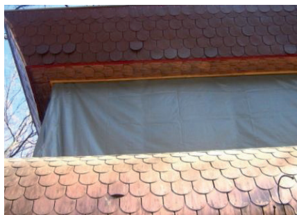
Ошибки: лепестки рядовой черепицы на отвесной вертикальной поверхности дополнительно не были промазаны битумной мастикой
