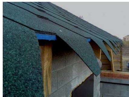
Ошибки: лепестки черепицы свисают с карниза, отсутствует карнизная планка, а также ветровая доска и подшивка карнизного свеса
