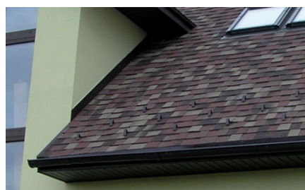
Ошибки: отсутствует верхняя планка примыкания
